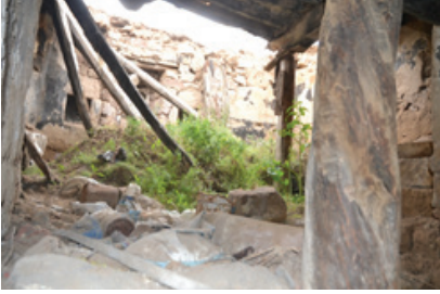
Foto 16: Odanın Yıkılan Girişi
