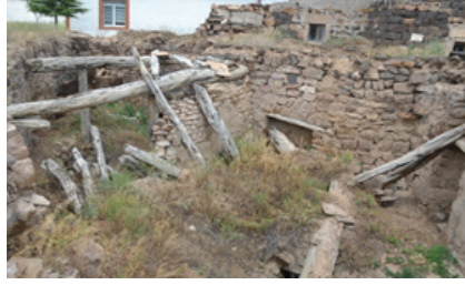
Foto 5: Odanın Yıkılan Üst Örtüsü
