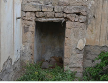
Foto 38: Kuzey Cephedeki Yıkık Ocak Detayı
