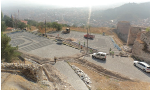
Foto. 11: Yukarı Kale. Kafeterya ve otopark alanında gerçekleştirilen kanal çalışmaları (Kütahya Kalesi Kazı Arşivi)
