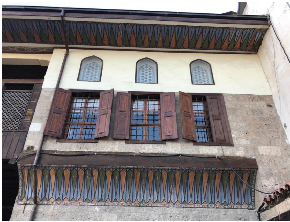
Şekil 6: Taşoda Konağı kahvaltılı salonunun güney cephesinde, sivri ke- merin üzerinde yer alan birinci katın çıkma altı
