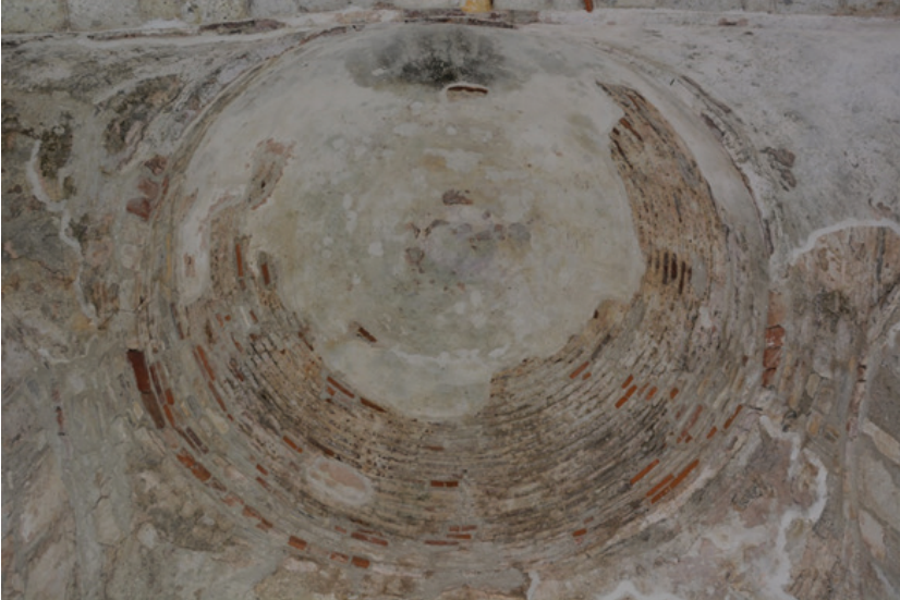
Fot.13- Eski Çeşme (İsmailobası) Köyü Camii. Konservasyon sonrası son cemaat yeri kubbelerinden. (Aralık 2022).
