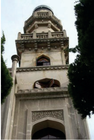
Görsel 15: Kobe Cami Minare detay
