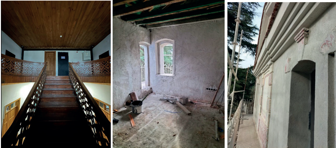
Görsel 37, 38, 39: Bursa Hamidiye Ziraat Mektebi, çatı katına çıkış merdiveni (05.12.2023), doğuda yer alan oda ve çatı katı balkonu (09.12.2022).
